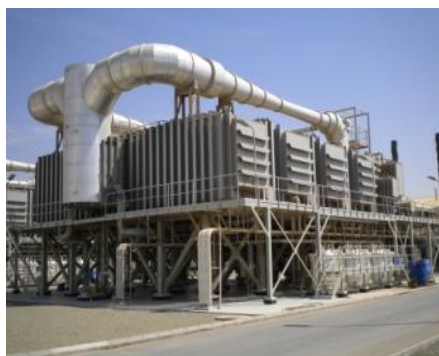
中東で活躍！省エネタイプ 陸上用海水淡水化装置 Reheat-type desalination plant for land use
